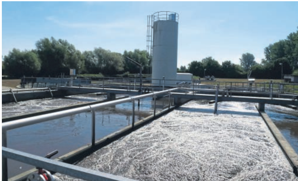
Im Belebungsbecken wird das Wasser gereinigt. Während der Reinigung wird ein Teil der Phosphate über die Nährstoffaufnahme der Bakterien dem Abwasser entzogen.
